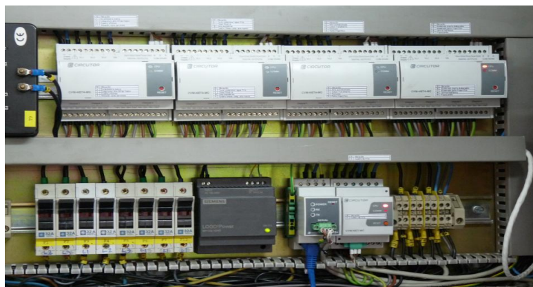
ILUSTRACIÓN 10. ANALIZADORES DE REDES Y SISTEMA DE COMUNICACIONES PARA LA MEDICIÓN Y REGISTRO DE CONSUMOS ENERGÉTICOS EN UNA PLATAFORMA DE MONITORIZACIÓN Y CONTROL EN UNA PLANTA INDUSTRIAL
