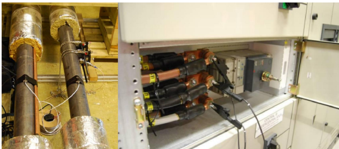
ILUSTRACIÓN 13. MEDIDOR ULTRASÓNICO DE FLUJO Y CALOR (IZQUIERDA) Y MEDIDOR DE TENSIÓN EN EL CUADRO ELÉCTRICO DE UN ASERRADERO (DERECHA). FUENTE: ECOINFLOW, 2013
