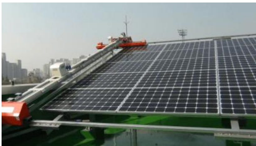
ILUSTRACIÓN 22: ROBOT PARA LA LIMPIEZA DE PANELES SOLARES. FUENTE: https://www.energias-renovables.com/fotovoltaica
