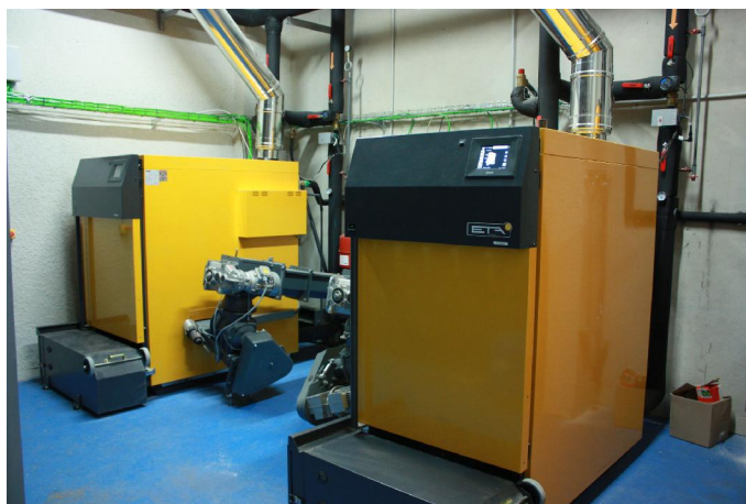
ILUSTRACIÓN 7: CALDERA INDUSTRIAL DE ASTILLA. FUENTE: ORLEGUY
