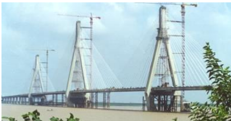
ILUSTRACIÓN17. EJEMPLO DE AISLANTE DE MOVIMIENTO MAGNETOREOLÓGICO PARA CONTRARRESTAR RACHAS DE VIENTO. PUENTE DEL LAGO DONG TING EN CHINA
